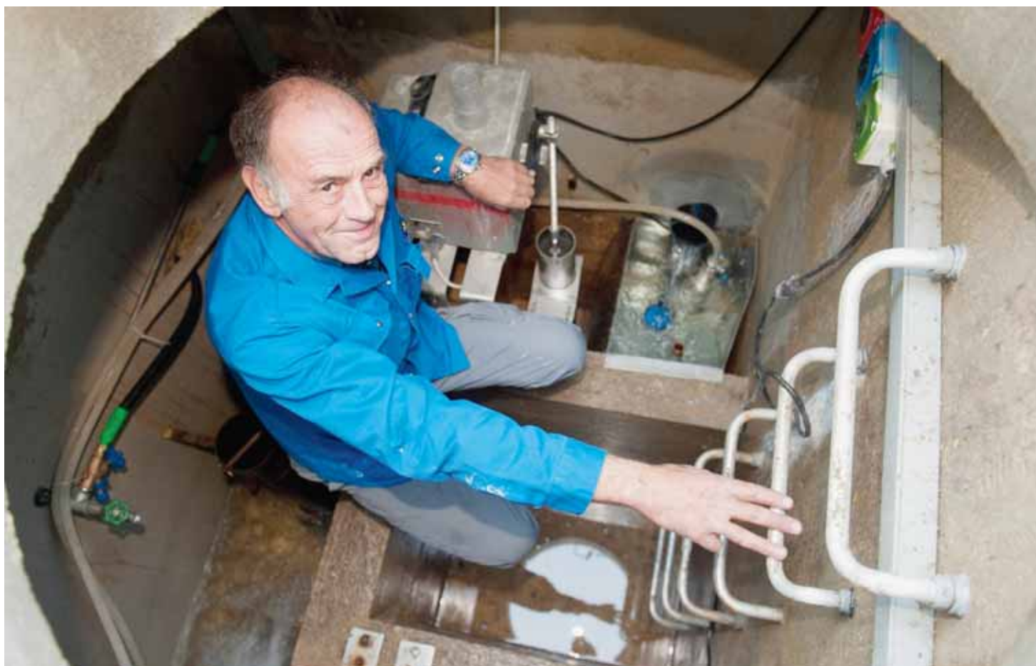
Le fontainier Jean-Louis Schneiter, ici dans les installations des Combes-Dernier dévoilera tous les secrets de fabrication d'une bonne eau samedi 22 octobre lors de portes ouvertes. DAVID MARCHON
