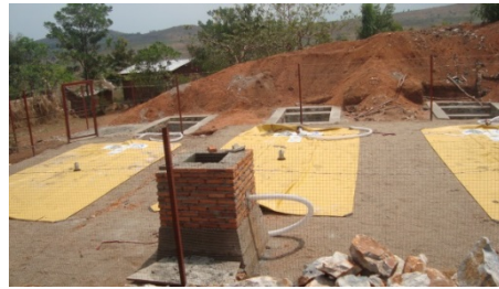
◀ Figure 7 3 réservoirs flexibles de 10m 3 à Mitakataka
