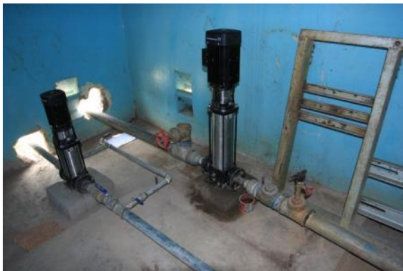
Grundfos CR 3 – 15 et pompe existante (eau du lac)
